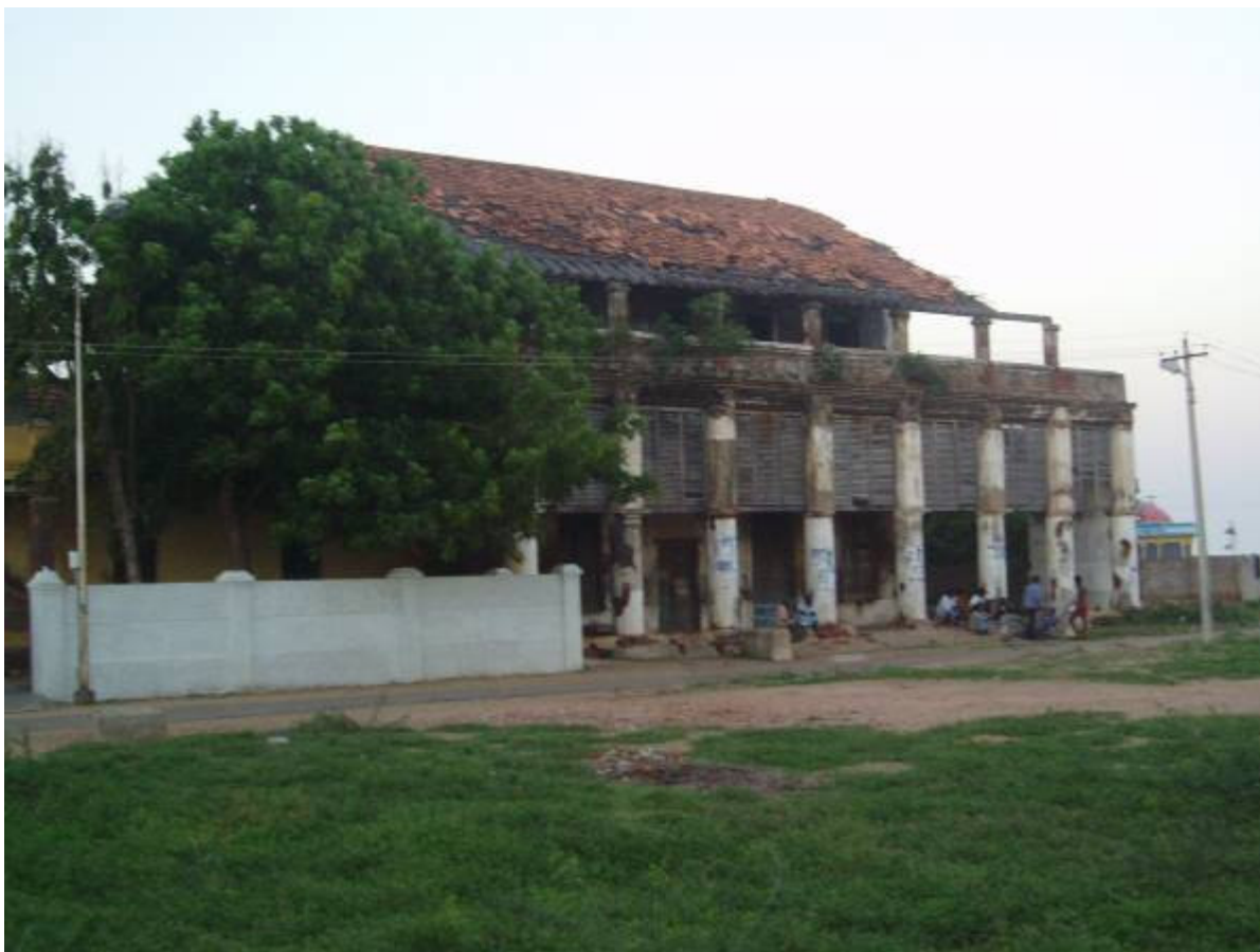
Guvernørens Hus var omkring 1800 et stateligt hus kendt og beundret videnom. I dag er bygningen tæt på at være en ruin, og da de tilbagevendende monsuner øger nedbrydningen kraftigt, er det i sidste øjeblik med en restaurering, hvis bygningen skal reddes. Foto: Einar Lund Jensen.
